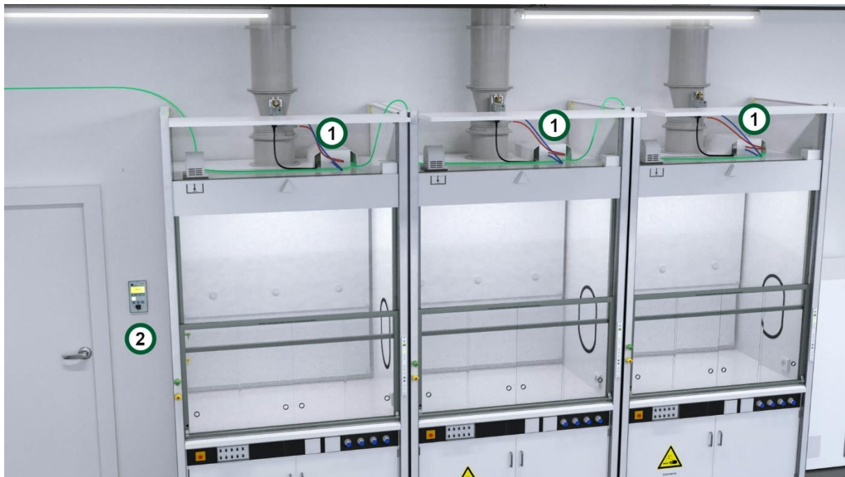
Abbildung 14, Standardlabor mit Vernetzung und Bilanzierung über Modbus
